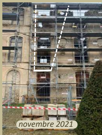
brèche ouverte sur 1 ère travée
